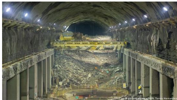
Figura 6 – Hidroelétrica de Ituango: vista do interior.
